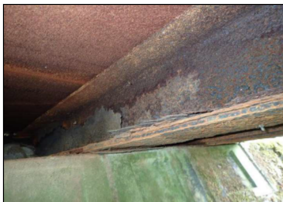
鋼桁の腐食等
