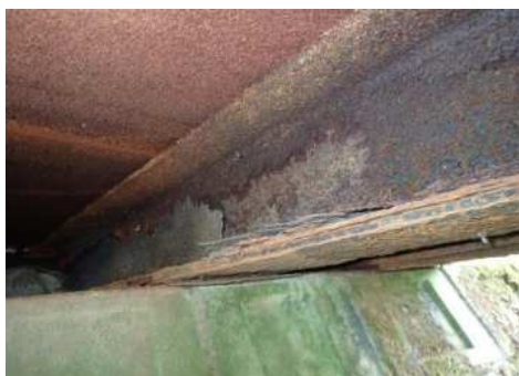
鋼桁の腐食等
