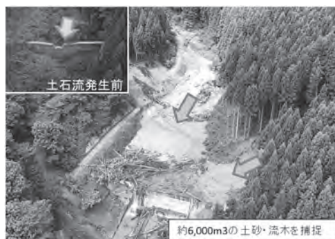
大量の土砂を捕捉した下土沢砂防堰堤（下土沢地先）
